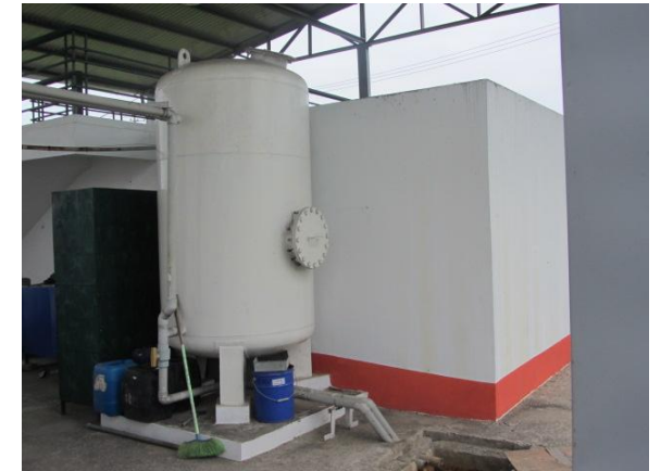
汉达越南过滤水塔
